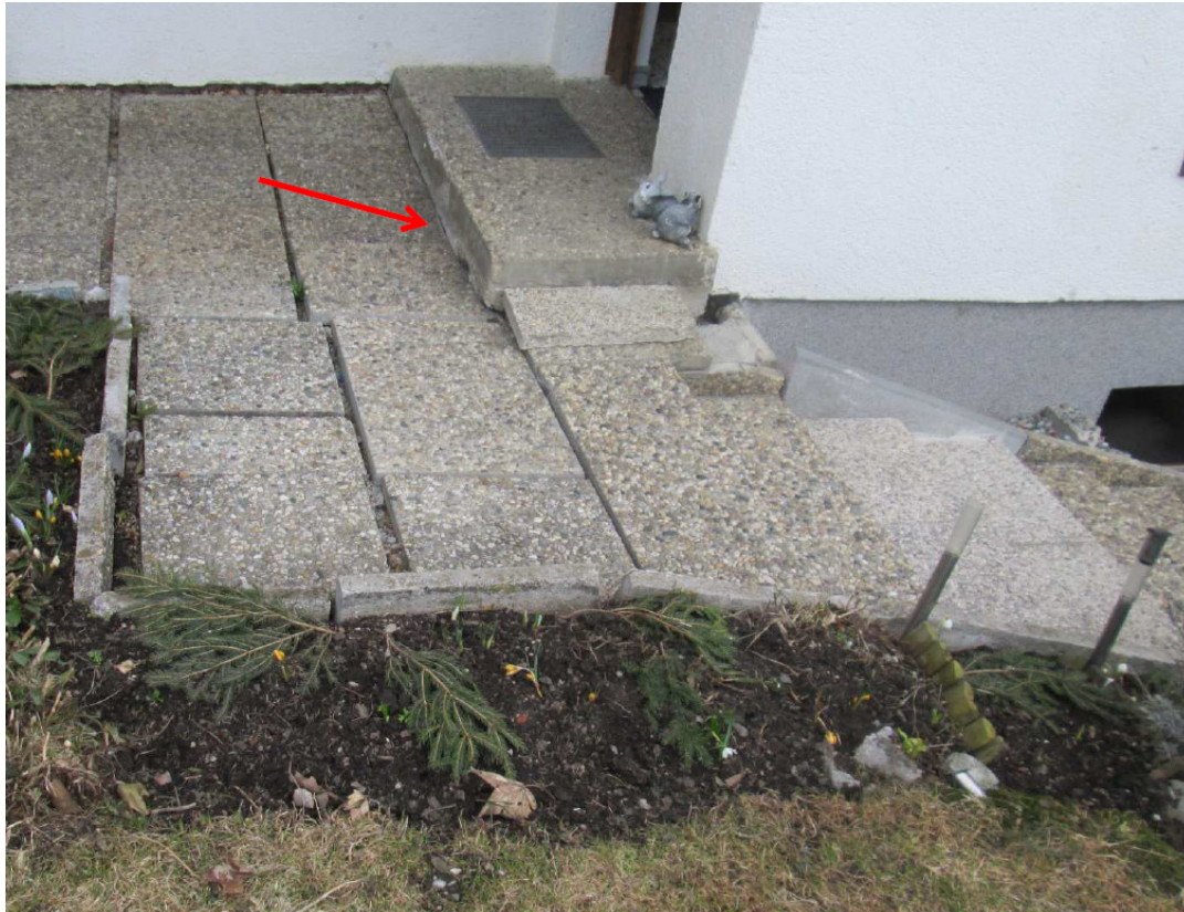
Bild 4: beim Hauseingang verschieben sich die Waschbetonplatten bereits unter den Eingangssockel. Die Setzungsmulden im Vordergrund werden immer wieder frisch aufgefüllt.
