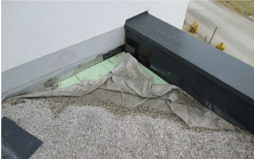
Bild 13: Wasser staut sich am Hochpunkt der Garagendecke
