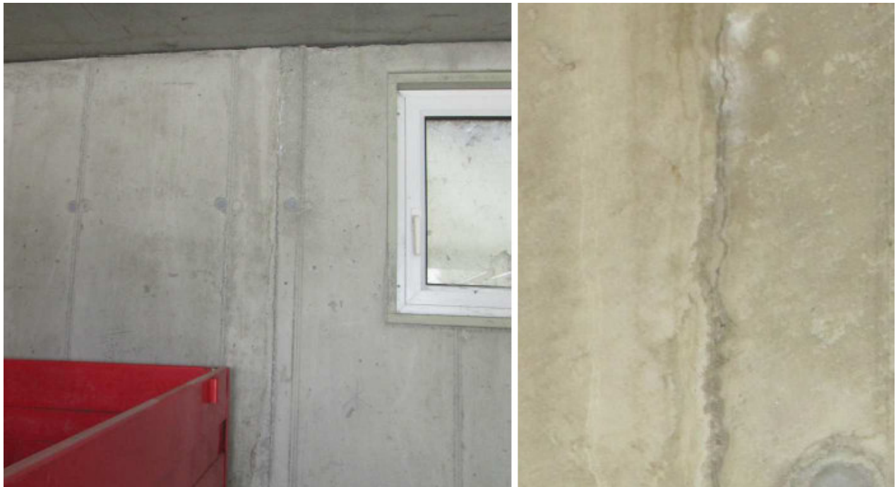
Bild 21 & 22: ein Riss in der bergseitigen Außenwand ist Wahrscheinlich nicht durch Setzungen
