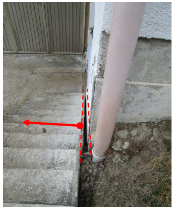
Bild 42: mehrere Zentimeter Spalt
