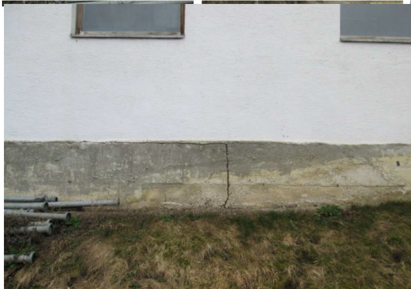
Bild 46: Riss in Fundierungs-Mauer
