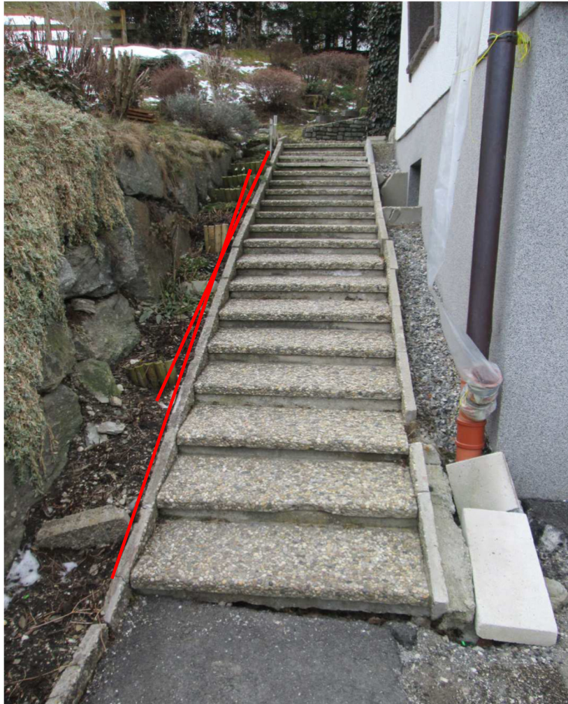
Bild 2: Treppenaufgang zum EG (lt. Eigentümer hatte die Treppe bei der Herstellung eine konstante Steigung, bei der Begehung wies die untere Hälfte markant mehr Steigung auf)
