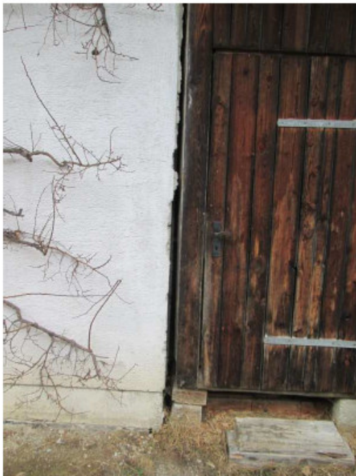
Bild 37: Spalt durch Verschiebung
