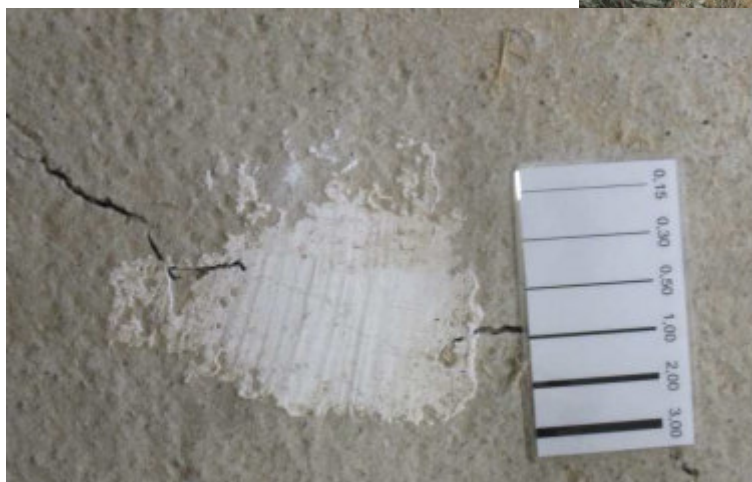
Bild 30: Gipsspion der Juni 2017 angebracht wurde und wieder neue Haarrisse zeigt
